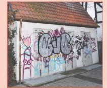
Das Trafo-Häuschen am Metzgeramts Haus wurde durch Schmierereien verunstaltet. Eine farbenfrohe Gestaltung soll das Häuschen zu einem Hingucker machen. Fotos: Schmitt
